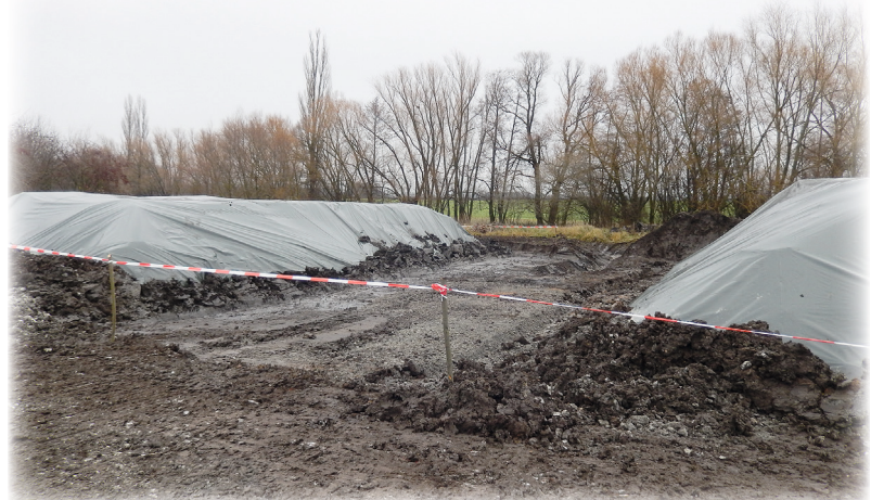
Kontaminiertes Erdreich in Mieten abgedeckt
